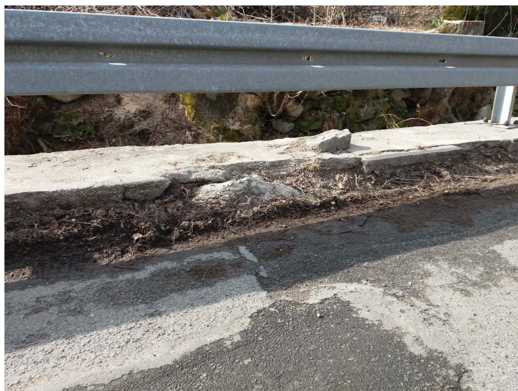
Zdjęcie nr 6 – zniszczone zwieńczenie muru.
