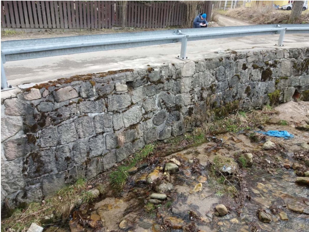
Zdjęcie nr 1 – ubytki w spoinach muru.
