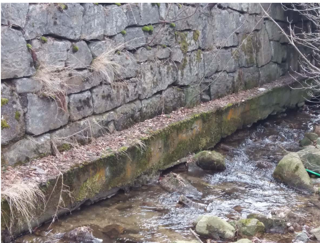
Zdjęcie nr 4 – zniszczony fragment fundamentu muru.
