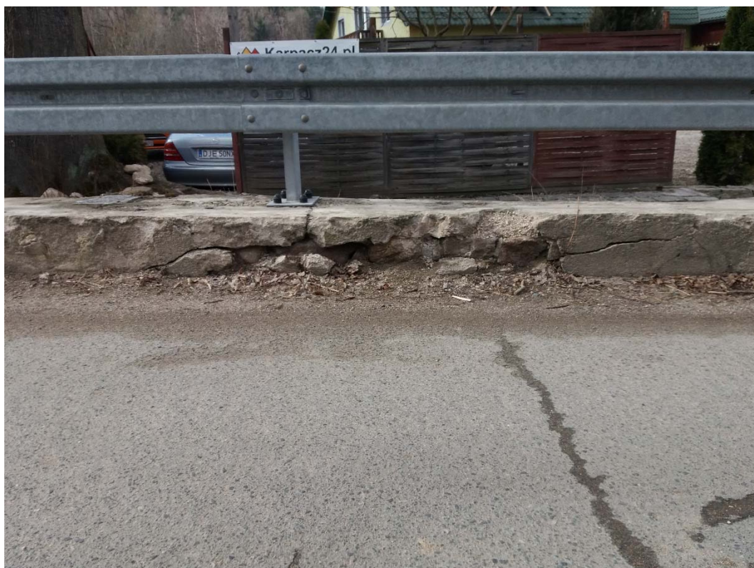
Zdjęcie nr 5 – zniszczone zwieńczenie muru.
