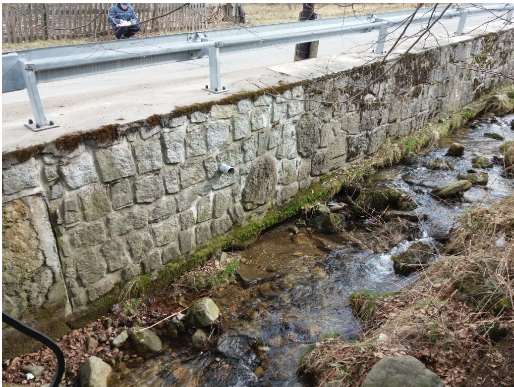
Zdjęcie nr 3 – zniszczony fragment fundamentu muru.
