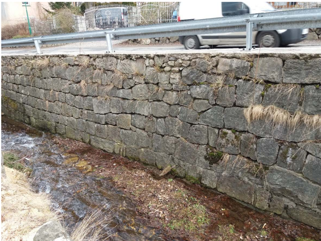
Zdjęcie nr 2 – ubytki w spoinach muru.
