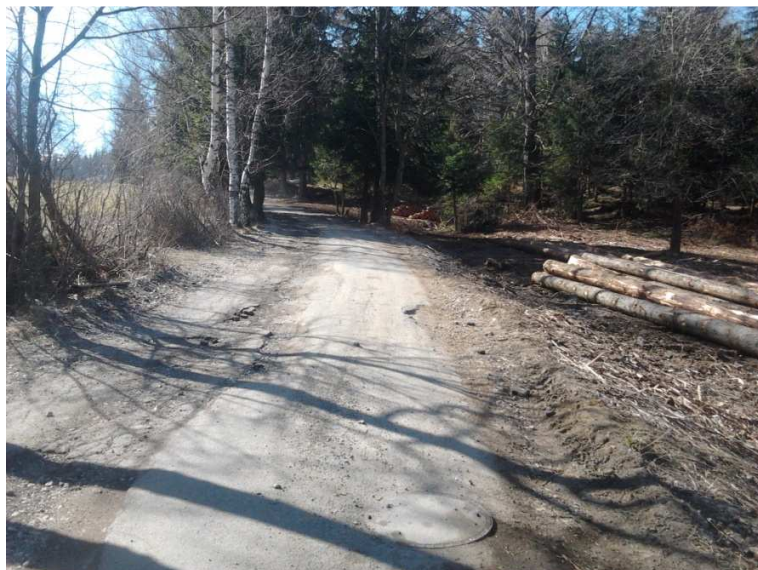
Fot. 1 Degradacja nawierzchni
