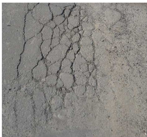
Fot. 2 Spękania nawierzchni
