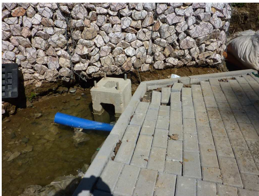
Fot.14 Wady ułożenia wzoru nawierzchni chodnika.
