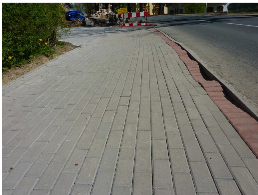
Fot.13 Nawierzchnia chodnika. Głębokość sfalowań dochodzi do 9 cm
