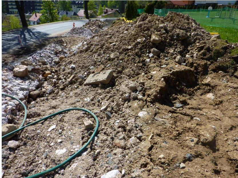
Fot.8 Naziom w środkowej części konstrukcji oporowej. Widoczne kraterki świadczące o intensywnym osiadaniu zasypki. Dodatkowe obciążenie zgromadzonym na klinie odłamu gruntem powoduje zwiększone parcie na konstrukcję
