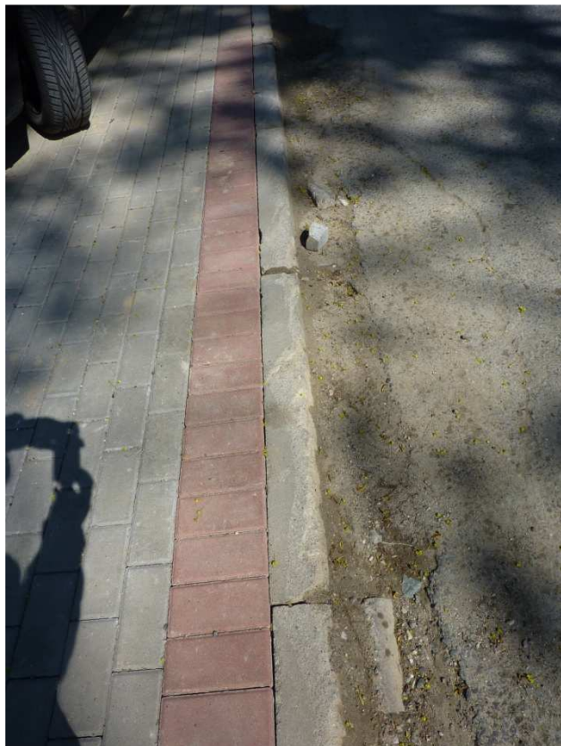
Fot.17 Uszkodzenia mechaniczne krawężnika w rejonie parkingu
