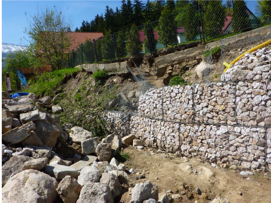
Fot.10 Osuwisko skarpy ziemnej w końcowej , niskiej części konstrukcji. Część ogrodzenia metalowego na ławie betonowej uległa zniszczeniu. Istnieje zagrożenie zawalenia się dalszej części ogrodzenia przedszkola.
