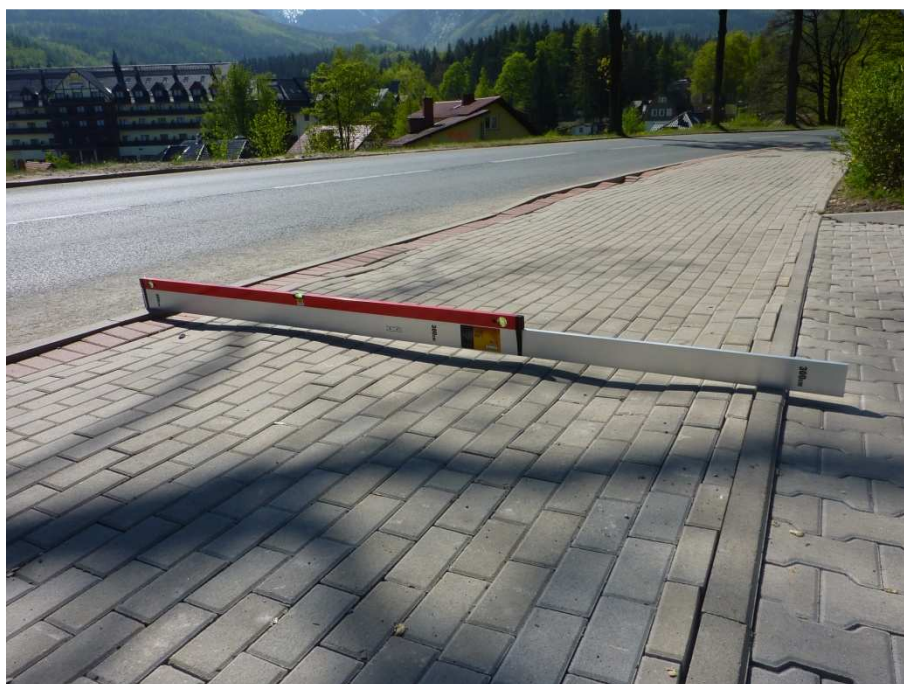
Fot.12. Pomiar równości poprzecznej ułożenia chodnika. Nawierzchnia chodnika ułożona poniżej górnej linii krawężnika drogowego.
