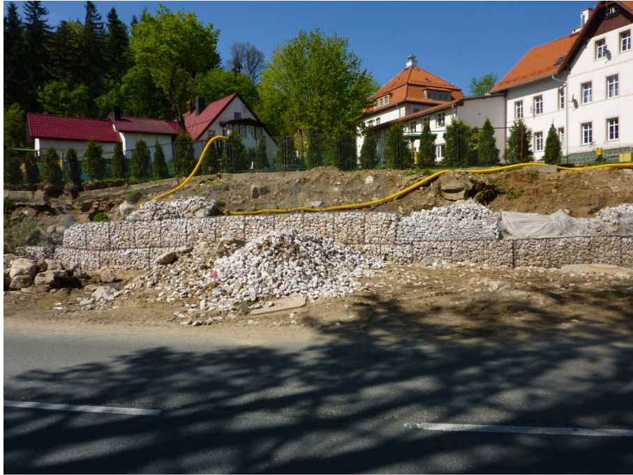
Fot.4 Niższa część konstrukcji oporowej o wys. 1,0m oraz 2,0 m. Widoczne nie liniowe ułożenie rzędów gabionów
