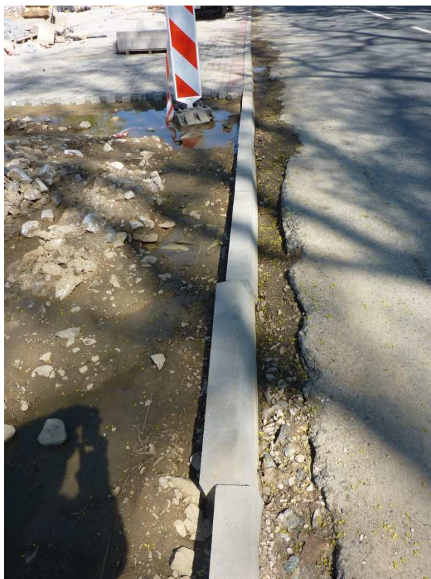
Fot.18 Brak liniowości ułożenia krawężnika, lokalne deformacje.
