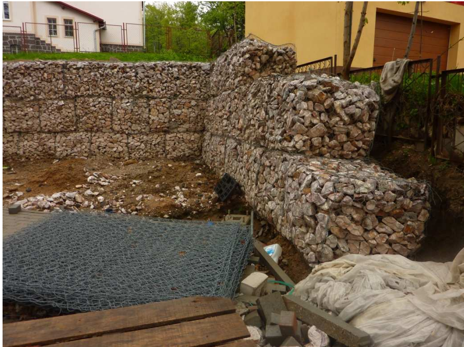
Fot.5 Narożny fragment konstrukcji oporowej. Zdeformowana geometria gabionów.
