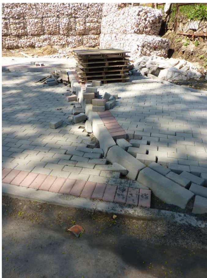
Fot.15 Miejsce połączenia chodnika z parkingiem. Krawężnik ułożony bez docinania
