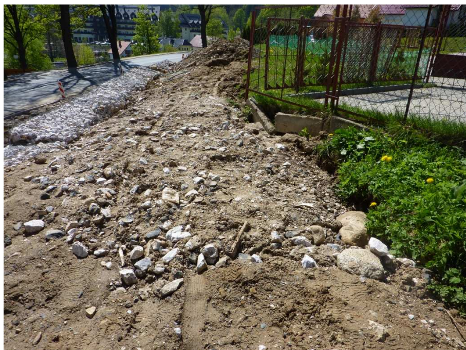
Fot.7 Poziom górny konstrukcji oporowej w okolicy budynku przedszkola. Szerokość klina odłamu około 3,0 m
