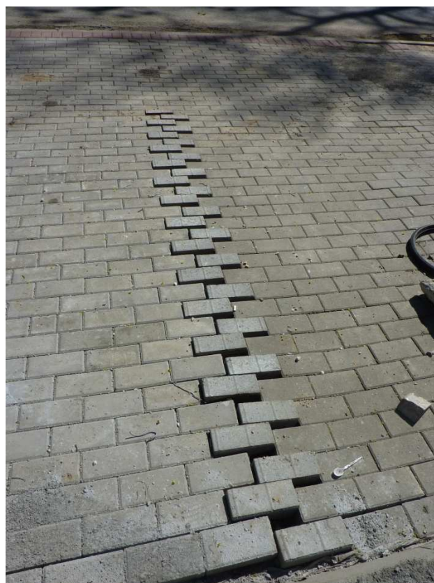
Fot.19 Nawierzchnia parkingu. Błąd wzoru ułożenia
