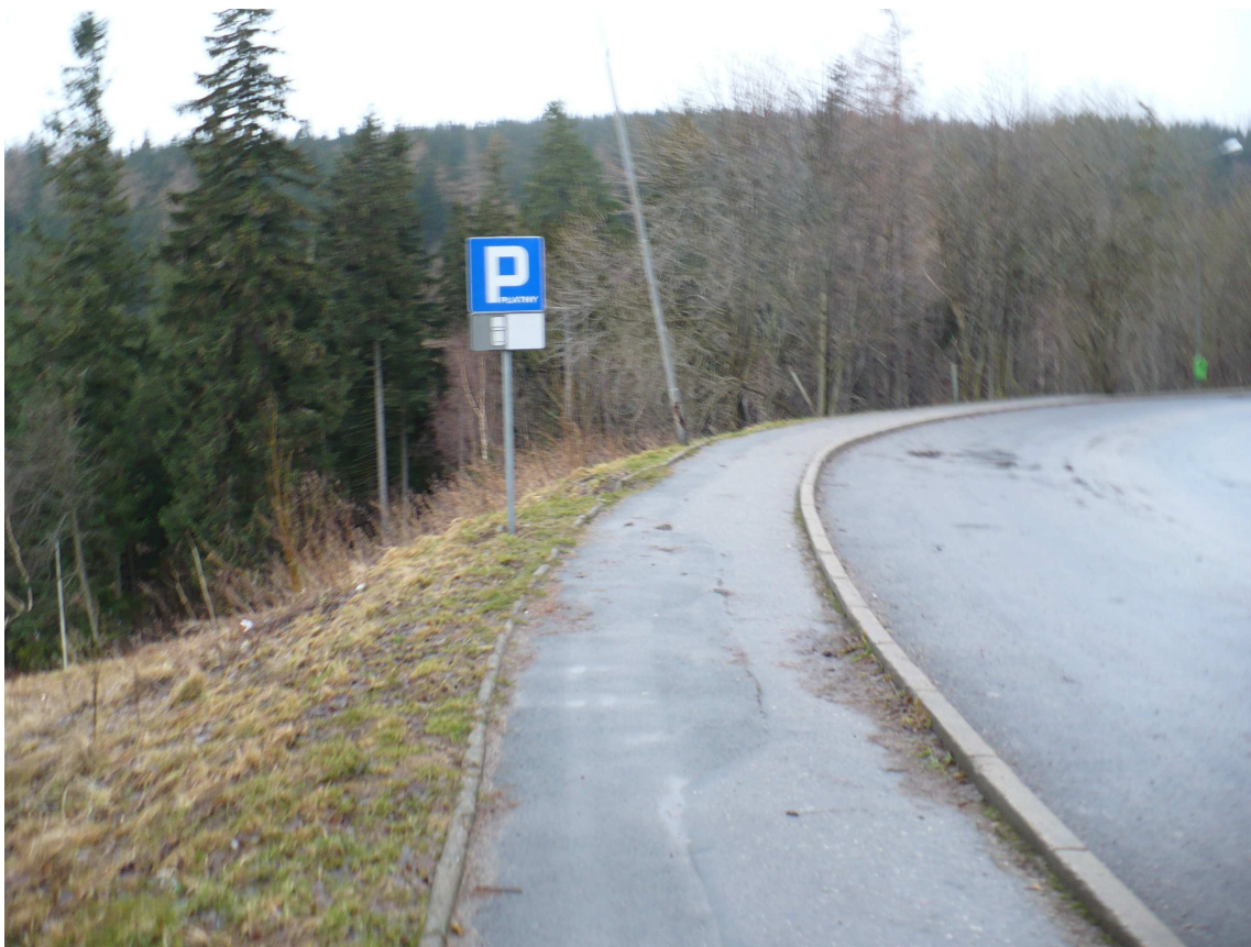
Fotografia 15 Skrzywiony słup oświetlenia ulicznego
