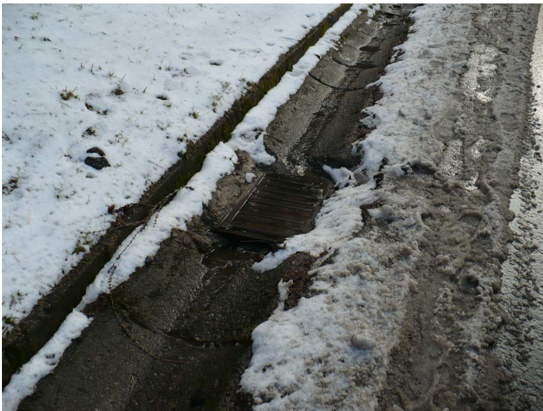
Fotografia 21 Niedrożny wpust uliczny w ciągu koryt betonowych
