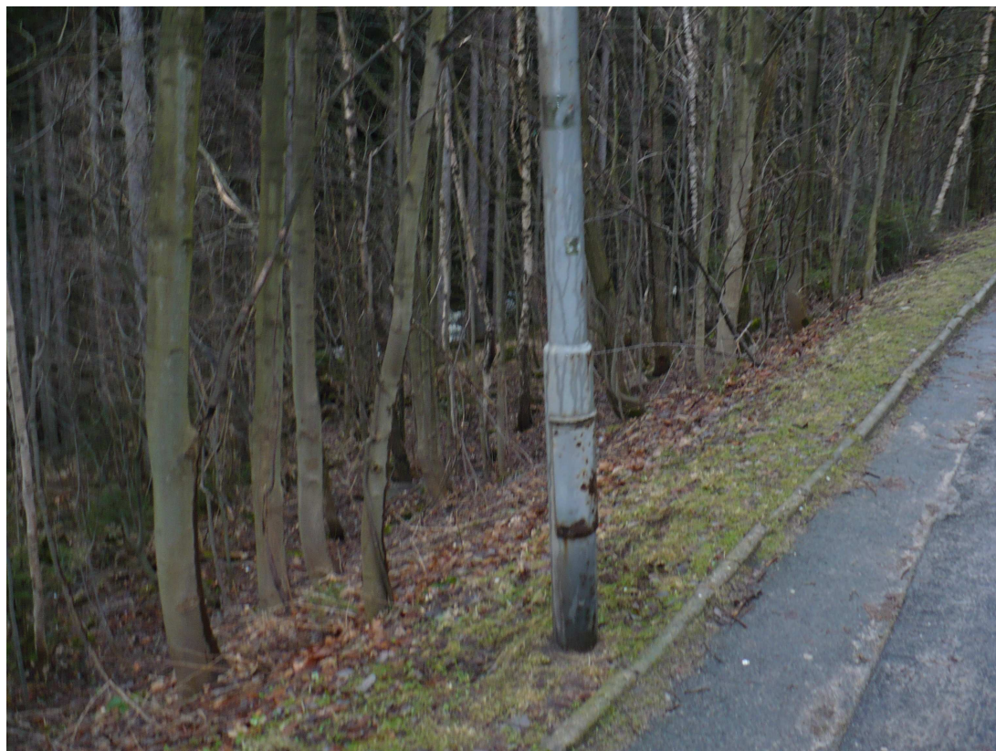
Fotografia 16 Stan słupów oświetlenia ulicznego
