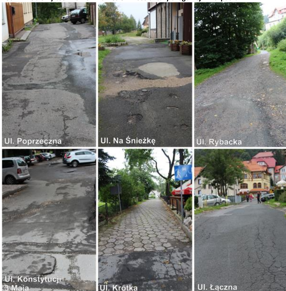
Fot. 2. Problemy techniczne w zakresie infrastruktury drogowej w Karpaczu
