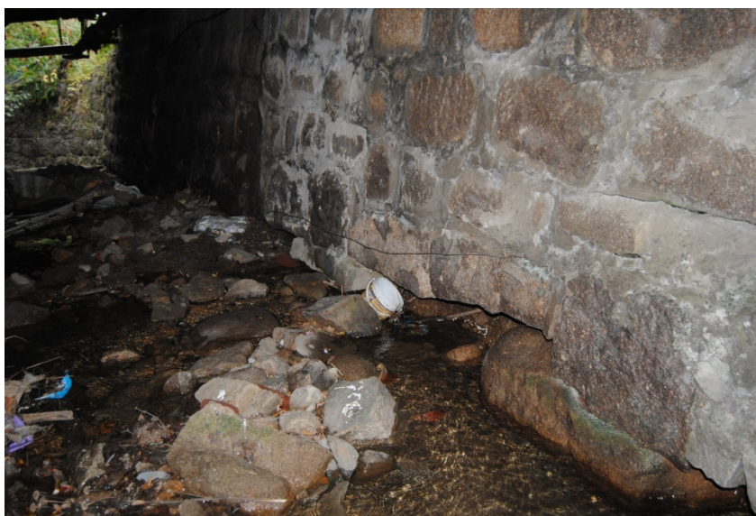
Uszkodzenia konstrukcji w poziomie lustra wody – ubytki muru kamiennego
