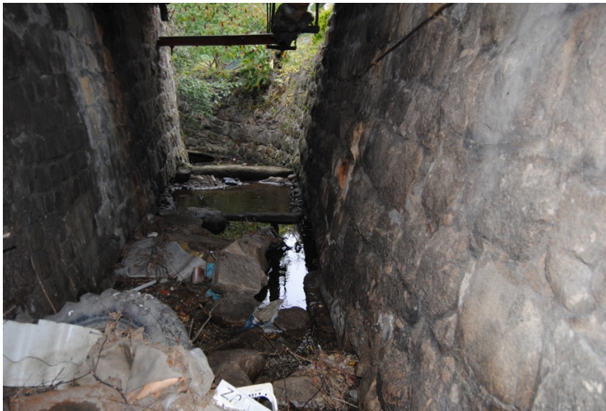
Stan dna pod obiektem – zanieczyszczenia i zniszczenie umocnienia dna
