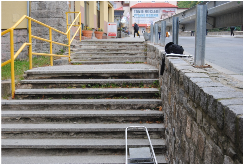
Uszkodzenia schodów w ciągu chodnika nad obiektem
