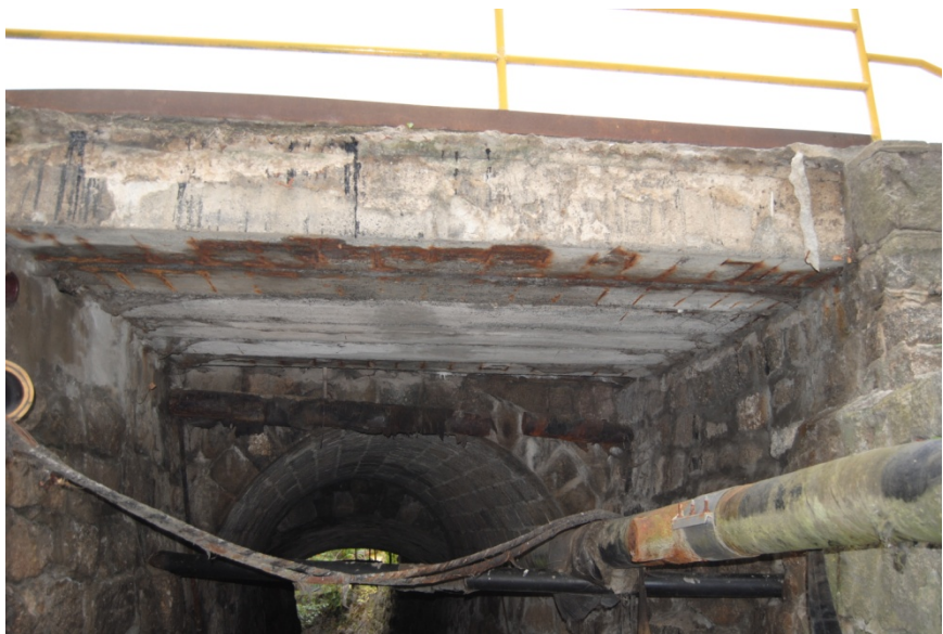
Uszkodzenia konstrukcji pod chodnikiem dla pieszych – ubytki betonu
