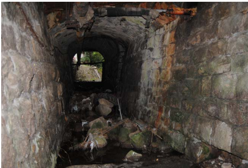
Stan dna pod obiektem – zniszczone umocnienie dna
