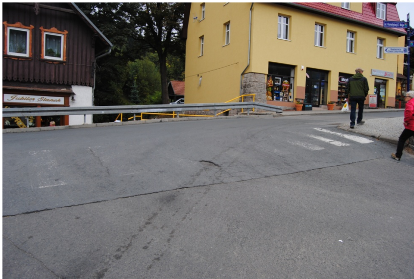
Jezdnia nad obiektem (ul. 3-go Maja), spękania i drobne ubytki
