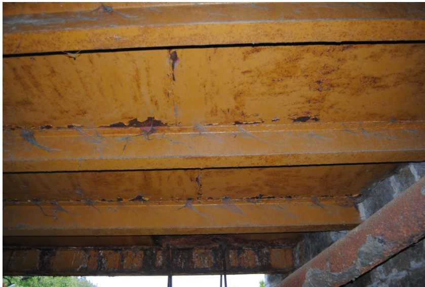
Konstrukcja od strony dolnej wody – korozja elementów stalowych
