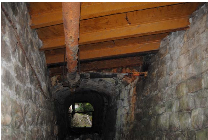
Stan urządzeń obcych na obiekcie – zniszczone elementy osłon i mocowań
